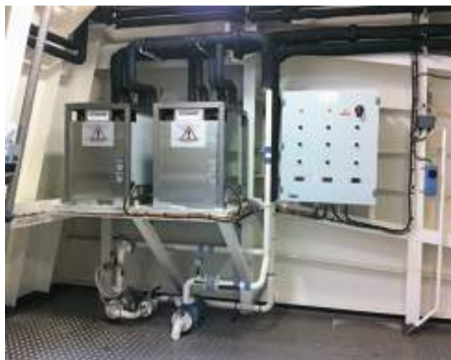
Centralina impianto condizionamento e riscaldamento Arcond
