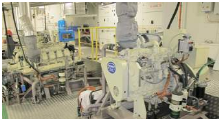
Veduta parziale della sala macchine della m/n Fabio Duò
